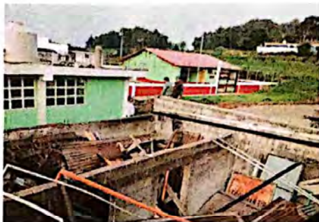
Foto 1: Sustrucción de Lámina
