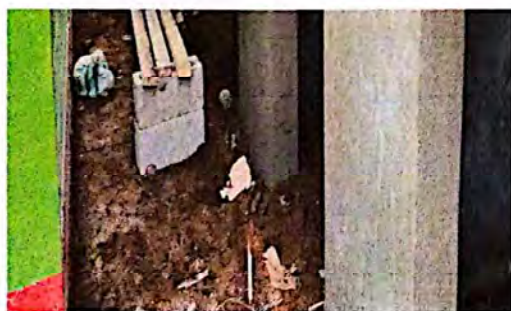
Foto 5: Sustrucción de piso cerámico
